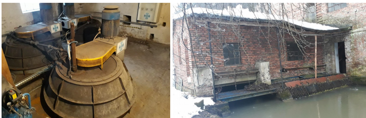
Rys. 16. Zespół turbinowy MEW w Okradzionowie (fot. po lewej) i budynek turbinowni (fot. po prawej). (autor fot.: P. Skwara)
